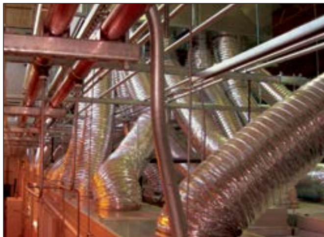
クリーンルームの大容量空調システム
